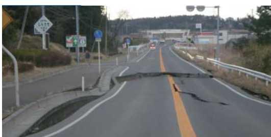
▲車道に約50cmの段差が発生し、通行不能となりました。
