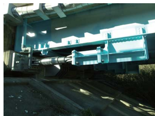
▲一般国道6号 高瀬川橋 (南相馬市) の耐震補強 (制震ダンパー設置) 状況
