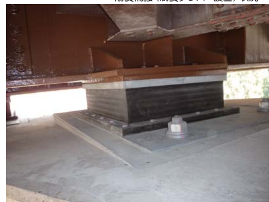
▲一般国道6号 上荒川橋 (いわき市) の耐震補強 (免震支承設置) 状況
