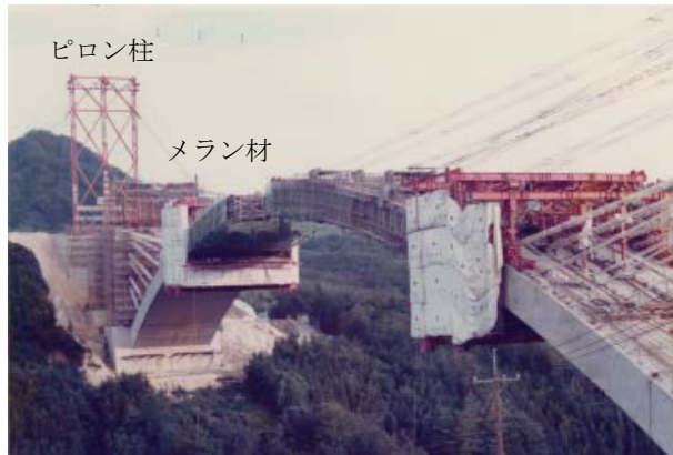
*8 [ピロン・メラン併用工法を採用した中国自動車道 宇佐川橋]
