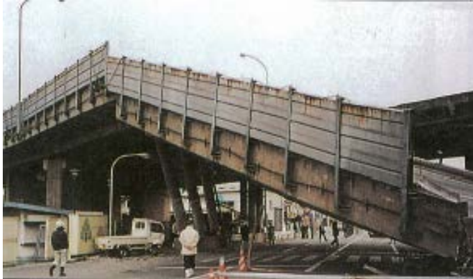
*4 〔阪神・淡路大震災被害状況(名神 瓦木西高架橋)〕 (『阪神・淡路大震災 災害・復旧報告書』・日本道路公団 大阪建設局 大阪管理局・平成10年3月)
