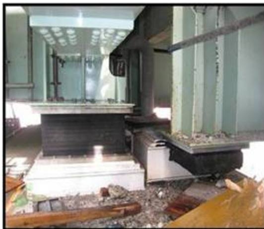
*3 【仙台東部高架橋のゴム支承の破断】
