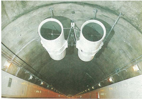
*9 [トンネル内の換気用ジェットファン] (『過去に学ぶ』・(財)高速道路技術センター・平成2年11月)
