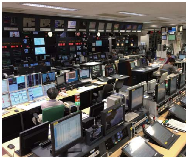
デジタル放送送出コントロールルーム
