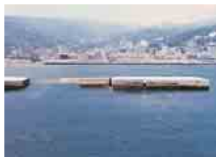
図 1-1-16 1982年 台風10号による 防波堤の被害(熱海港)
