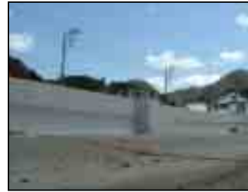
景観に配慮した護岸 (妻良漁港海岸子浦地区：南伊豆町)
