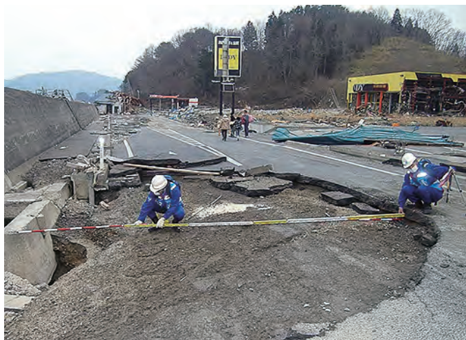
被災状況の調査を行う隊員
