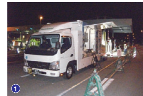
① LED照明を搭載した水素燃料電池電源車で夜間工事
