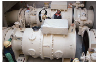
大型の雨水排水ポンプ
