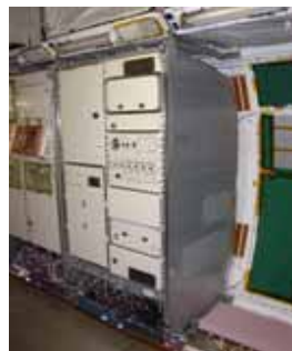
船内実験ラック
