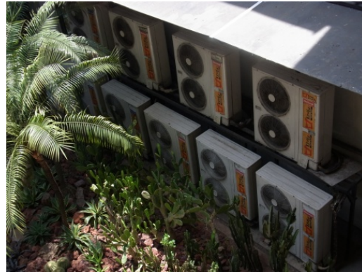
写真 3-12：後付の空調システム
