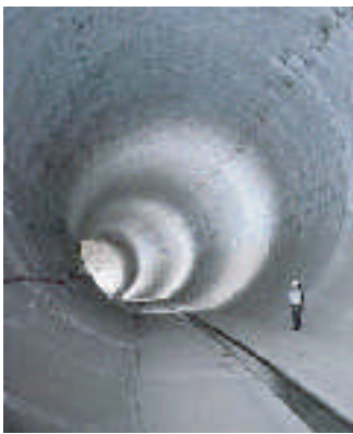
▲神田川・環状七号線地下調節地
