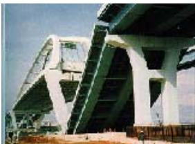
阪神高速道路の落橋 (西宮市甲子園浜)
