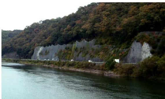
ロックネット等による緊急措置状況。 抜本的な対策が望まれる。
