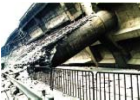
阪神高速道路の橋脚の被災 (神戸市東灘区深江本町)
