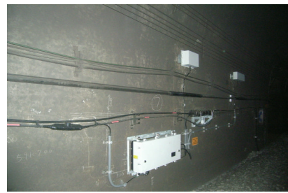
トンネル内子局装置
