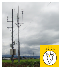
テレビ電波受信施設
