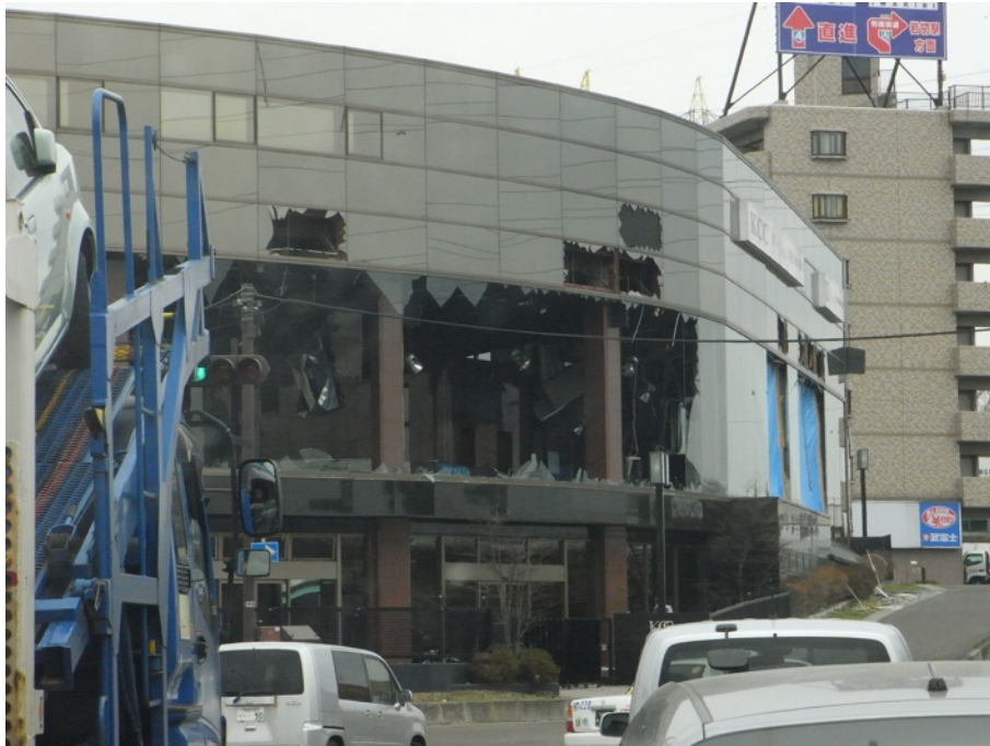
仙台市内 4月7日の地震によりファサードが破壊。
