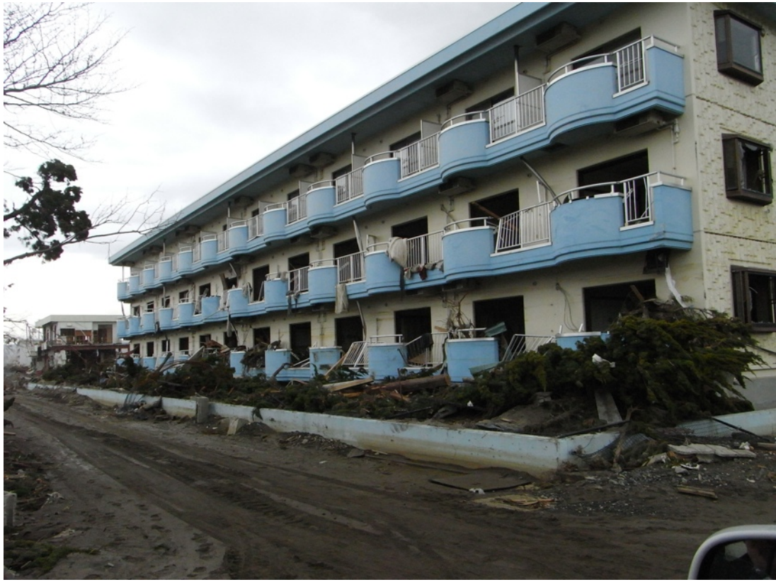
石巻市南浜町 2階まで津波の被害を受けている。
