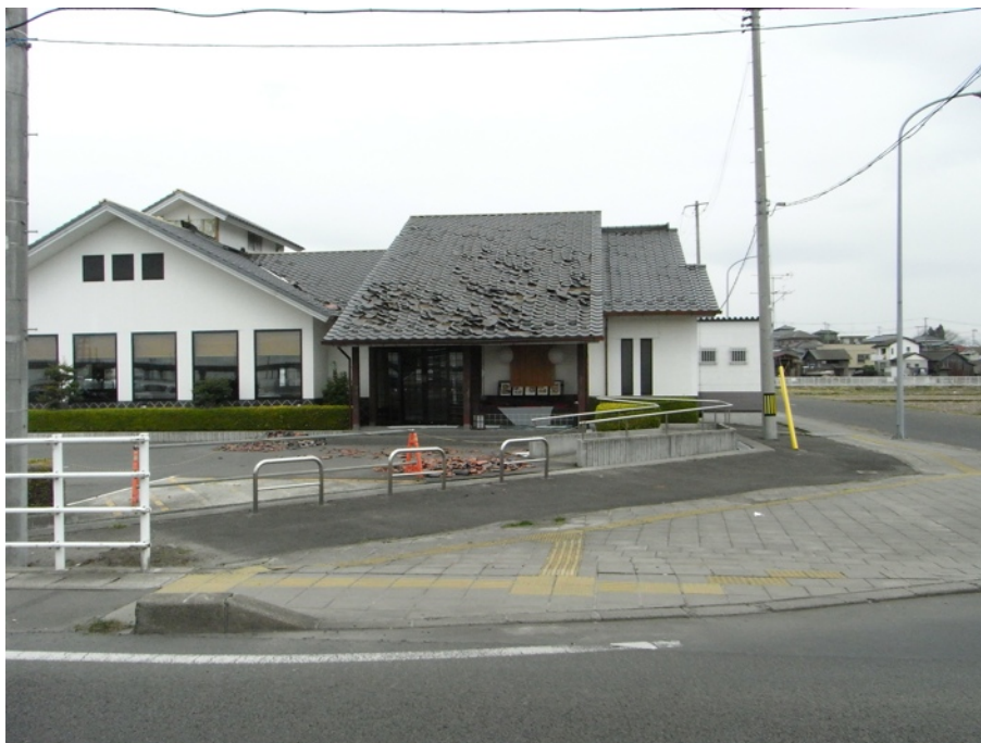
7日の地震によると見られる。瓦落下、窓ガラス破損。
