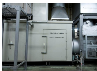
天然ガスを燃料とした自家発電設備
