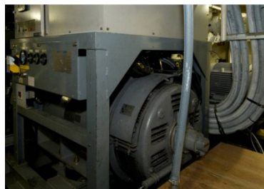
バージ内の発電機
