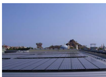
太陽光による自家発電設備
