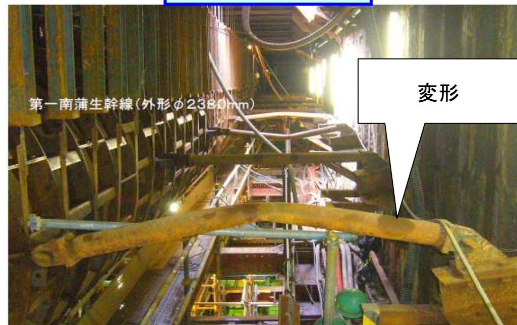
震災後の状況
