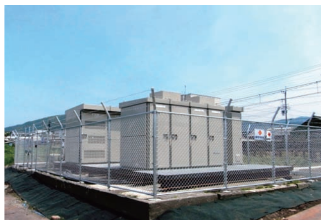
■ 西日本旅客鉄道向け電力貯蔵装置(美浜駅構内)
