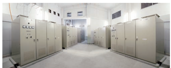
■ 東武鉄道向け電力貯蔵装置(上福岡き電区分所)
