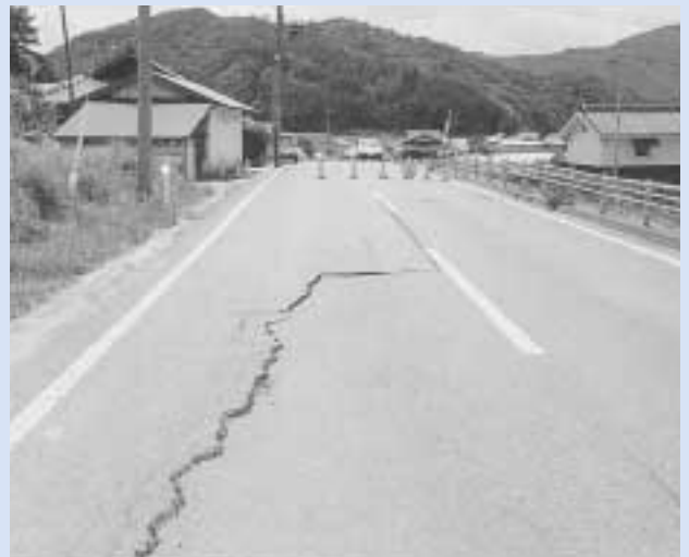
平成9年北部地震による県道のひび割れ（生雲地区）
