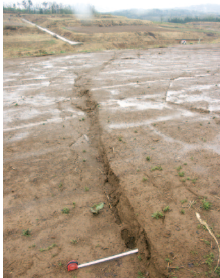
写真8 栄村大久保地区北東の農地で観察された地表面のずれ。
