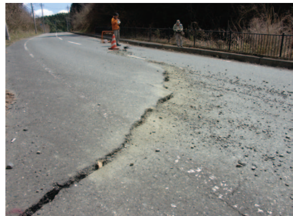
写真5 道路を横切る地表の亀裂（高萩市小山ダム付近）。
