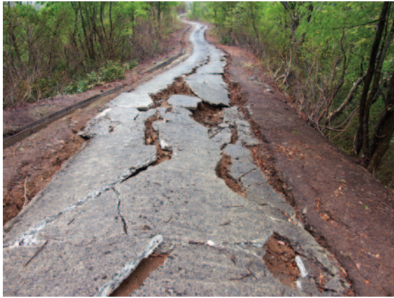
写真7 青倉断層通過地点付近の尾根上で観察されたコンクリート道路の損壊（栄村青倉，横倉沢川左岸）。
