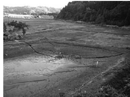
写真4 柵池クラック
