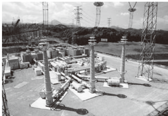
図 6.6 東京電力新榛名変電所 1,000 kV 実証試験設備
