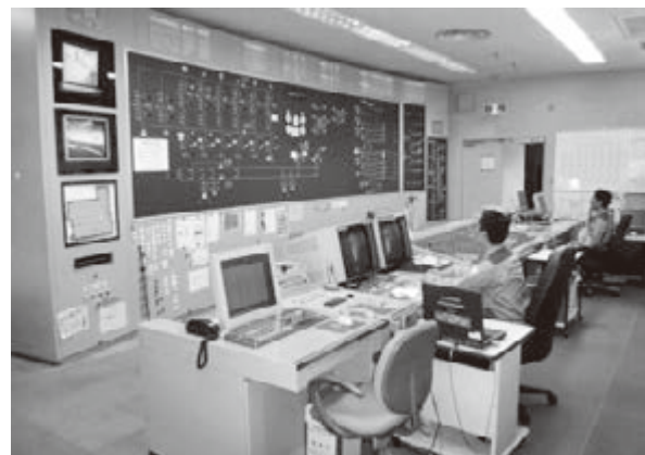
図 8.3 系統安定化システム BSS 運転室（関西電力） (8.3)
