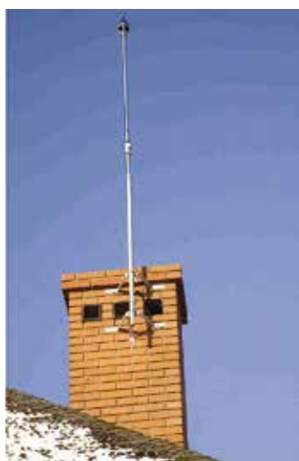
Rys. 6. Przykład bezmyślnej instalacji skopiowany z jednej z polskich stron internetowych
