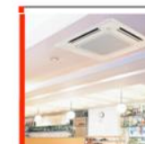
空調システム
