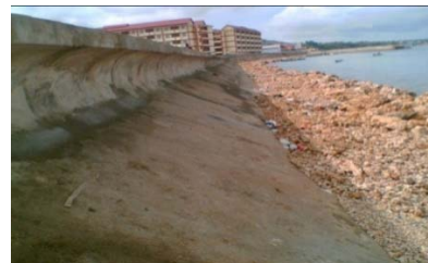
図 4-9 コンクリートブロック積護岸工 Pantai Banding BBWS Mesuji Sekampung
