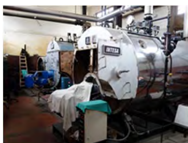
2基のボイラー（手前は修理中）
