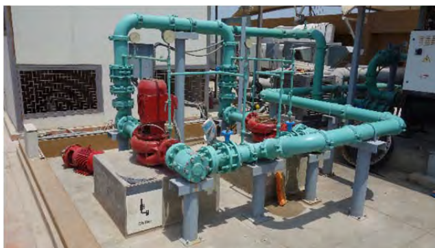
ランバイエケ州病院屋上チラーユニット（カナダTrane社製） ポンプの修理部品が届かない
