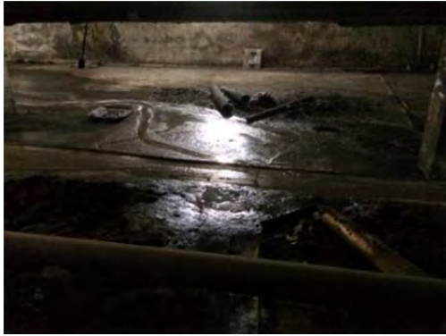
地下の漏水の痕跡
