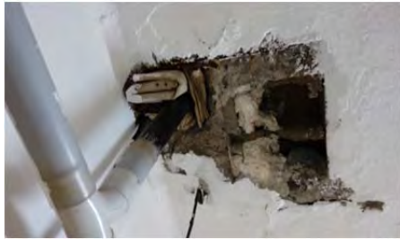
無造作に開けられた設備配管のための穴
