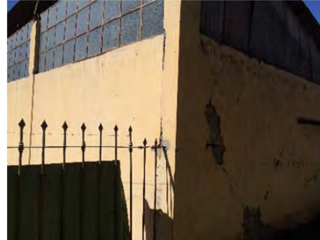
構造亀裂を放置したボイラー棟
