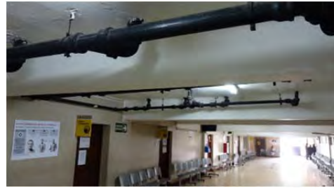
外来待合室廊下に露出した汚水配管
