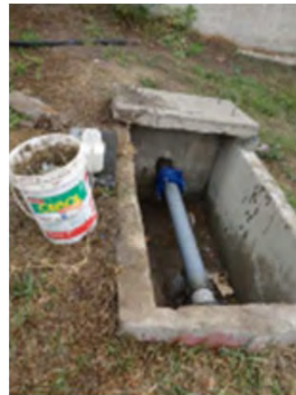
繋ぎ目が破損した市水引込み管
