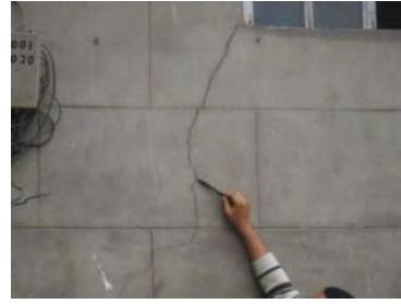
亀裂鉄筋の錆による コンクリートの爆裂
