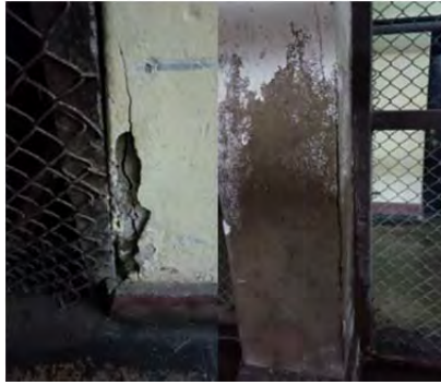
地下階の構造亀裂
