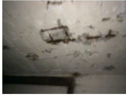
鉄筋腐食によるコンクリートスラブの剥落
