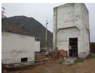
亀裂の為に現在使用されていない高架水槽
