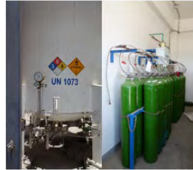
各種医療ガス設備（酸素、空気、吸引）
