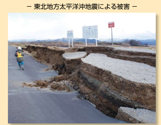
— 東北地方太平洋沖地震による被害 — ■ 阿武隈川下流における堤防の沈下
