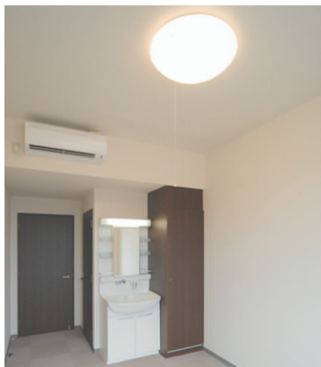
寮個室の照明(FCL40W+32Wシーリングライト)
