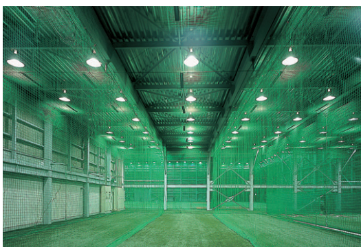
1軍バッティング練習場の照明：1kWメタルハライドランプ高天井用反射笠器具を整列配置
