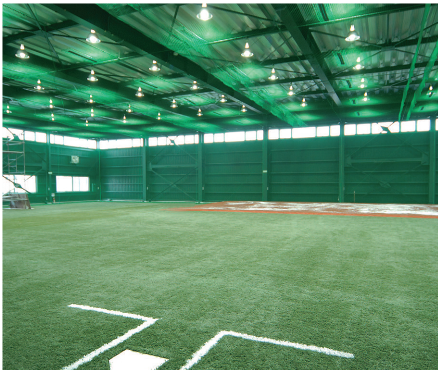
泉練習場の室内照明：400Wメタルハライドランプ高天井用反射笠器具(広照形)を防球ネット上部に整列配置
