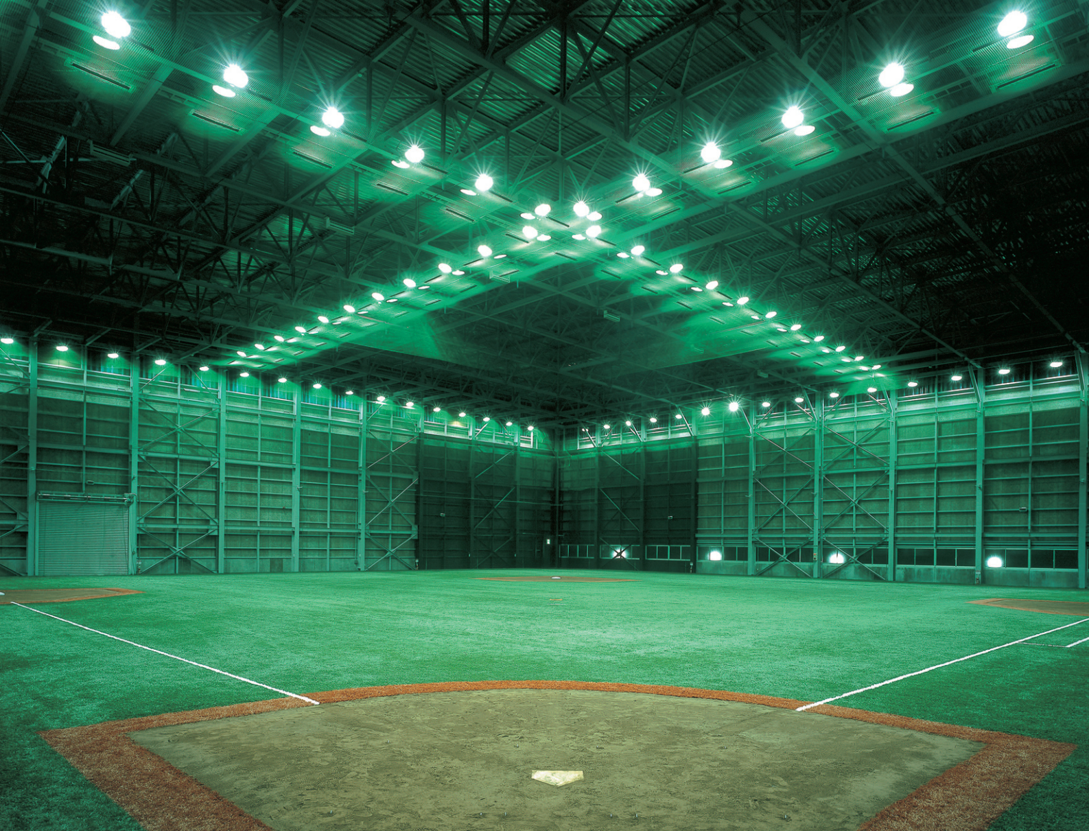
1軍室内練習場の照明：1kWメタルハライドランプ投光器を田の字形に配置。高照度を確保しながらグレアを低減
