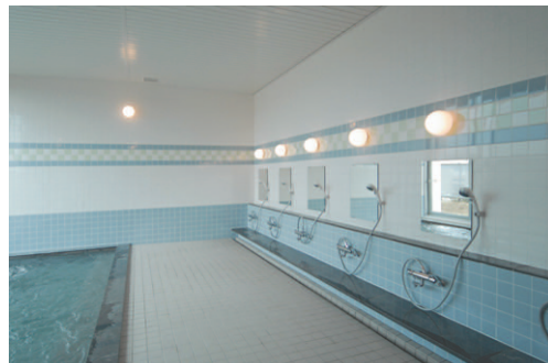
寮浴室の照明(EFD15Wブラケット)
