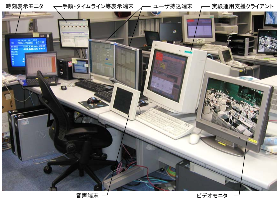
図 2.4.2-1 ユーザ運用エリア内の設備(一例)
