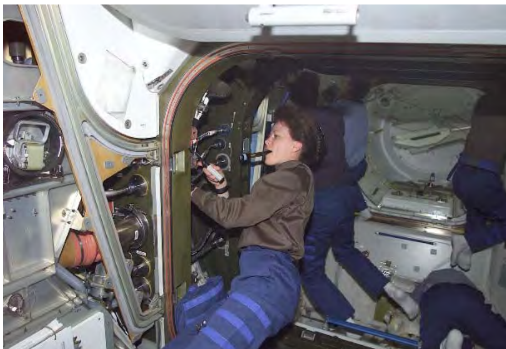
図3.3.4-9 米国のモジュール間での電力・通信・流体配管の接続作業
