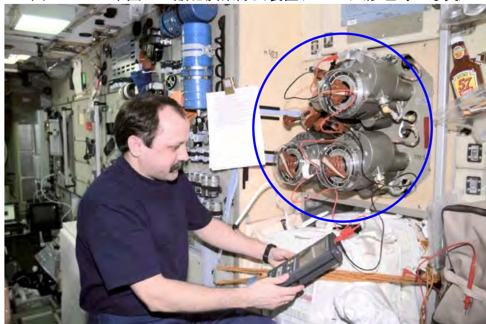
図3.4.2-5 ロシアのVozdukh (表面に見えているのはバルブパネルのみ)
