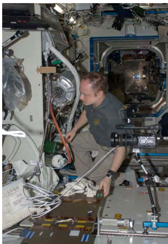
図3.3.4-10 水再生システム(WRS)ラック 尿処理装置のトラブル対応作業
