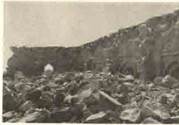
挿図6 M.15 崩壊後の状況(北より)
