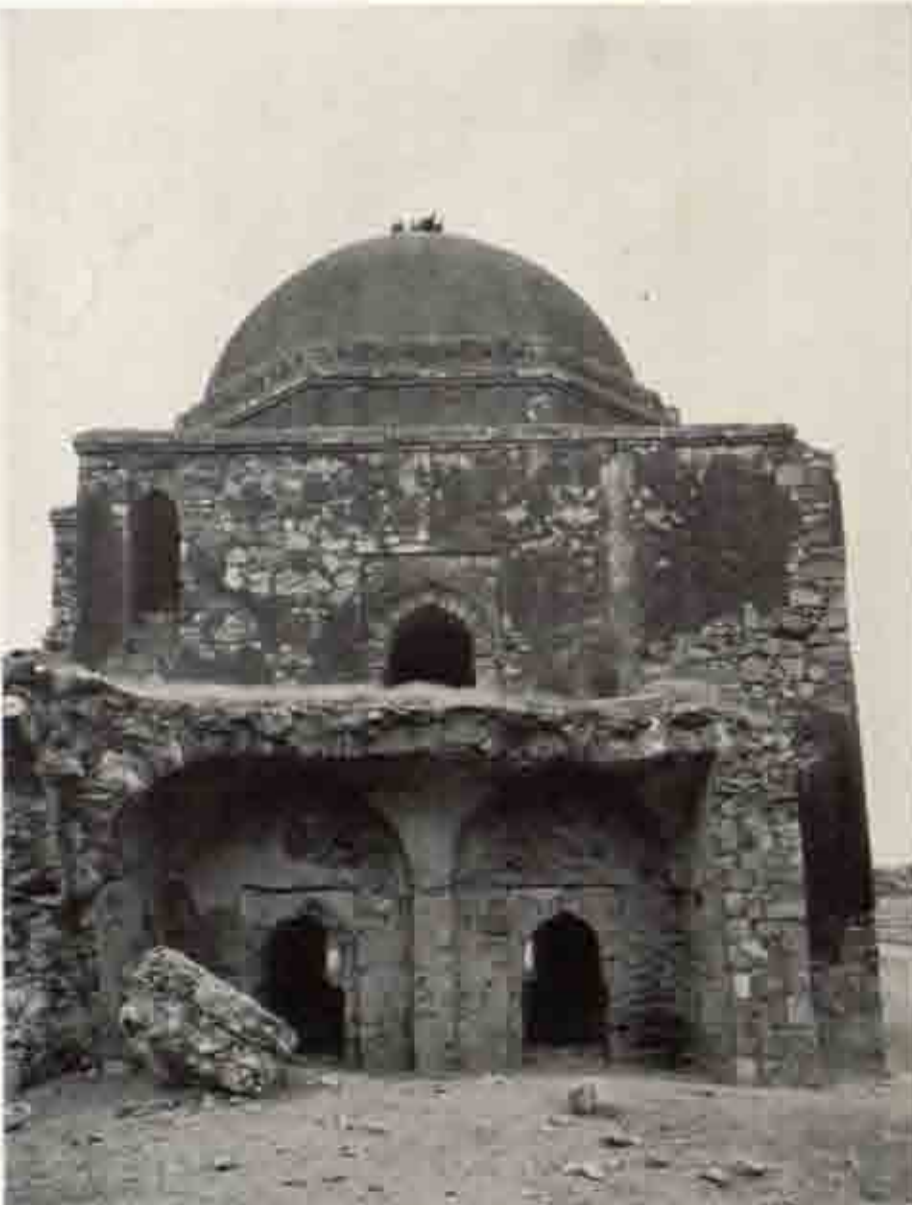
b M.10 同上 中央礼拝堂南面と崩壊した南無礼拝堂
