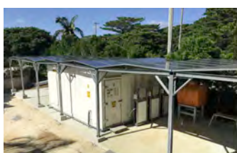
PVを設置した植物工場実験施設
