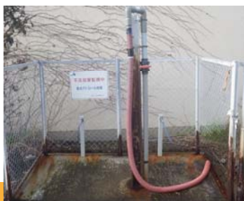
関門プラザ付近に設置された取水用バルブ
