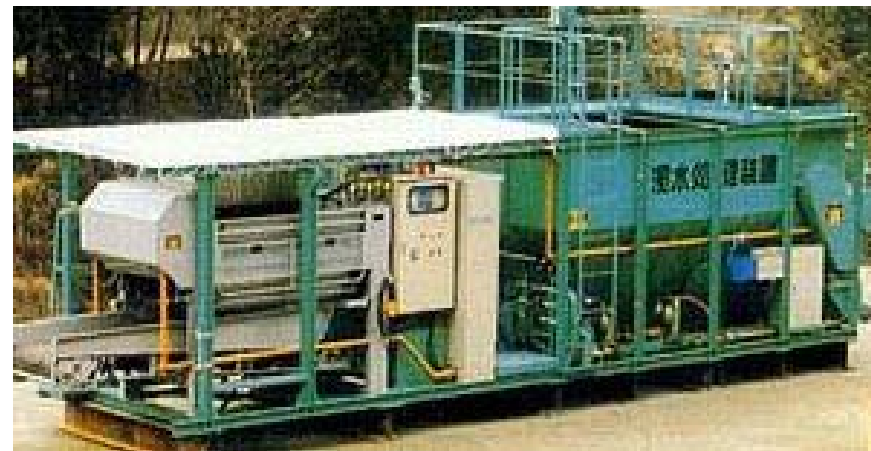
濁水処理装置の設置の例
