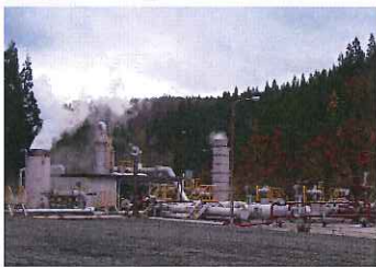
上の岱地熱発電所
