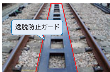
山陽新幹線逸脱防止ガード
