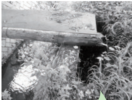
河川の護岸の裏側の土砂が流出している
