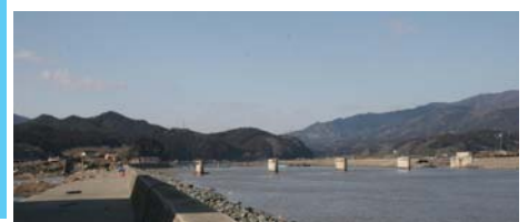
▲国道45号気仙大橋被災状況
