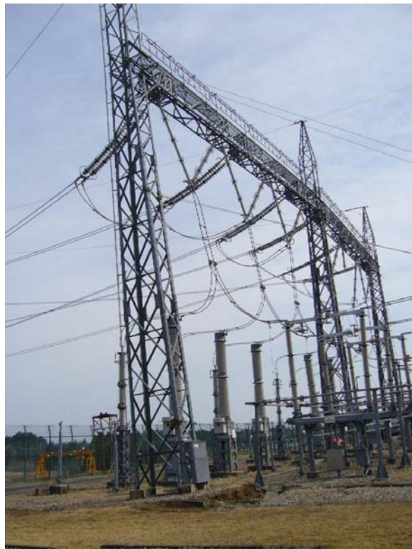
撮影：東京電力株式会社 H23.3.11
