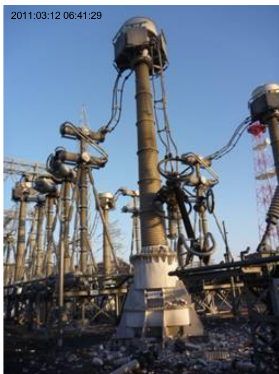
撮影：東京電力株式会社 H23.3.12
