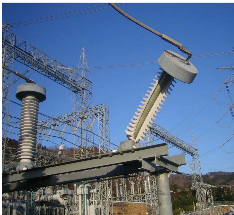
撮影：東京電力株式会社 H23.3.12
