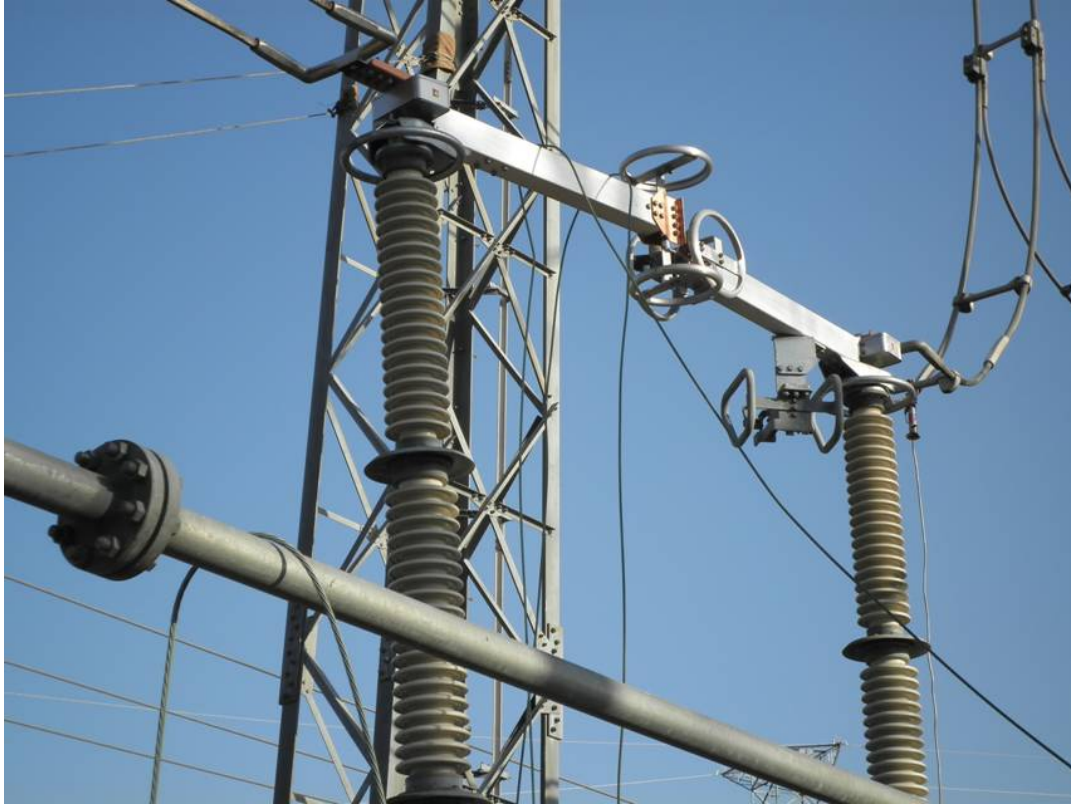
撮影：東京電力株式会社 H23.3.12
