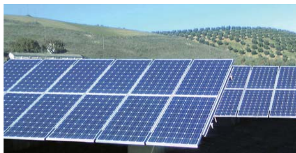
南イタリアに建設された太陽光発電所
