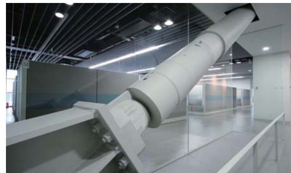
制震ダンパーが工場内に約570台配置され、地震による衝撃を吸収する
