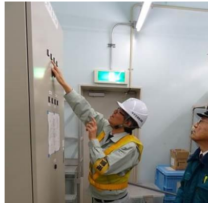
《電力設備巡回の様子》
