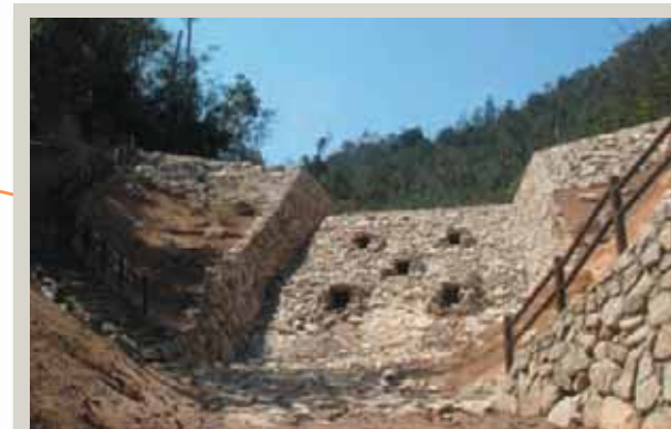
弥山原始林の自然環境保護に配慮して施工した1号えん堤
