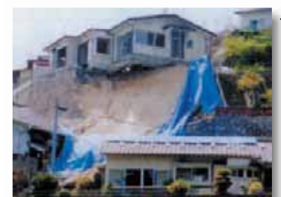
◀宅地擁壁の崩壊(呉市)民間宅地の擁壁が多数崩壊しました。
