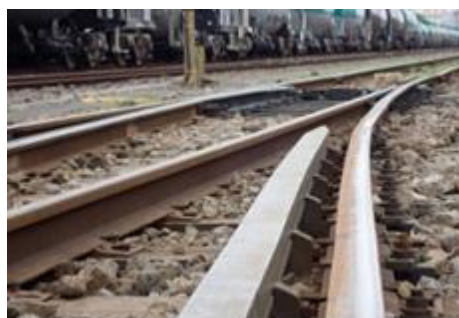
脱線防止ガードレール
