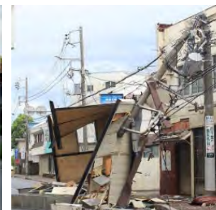
<飛来物による電柱倒壊の事例>
