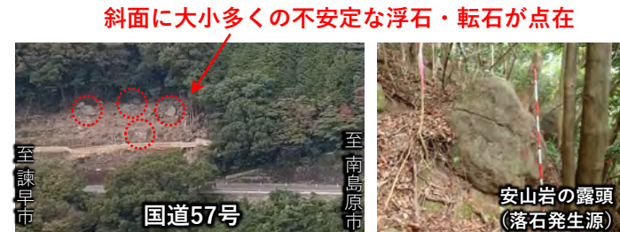
写真③ 国道57号の上空斜面に存在する浮石・転石
