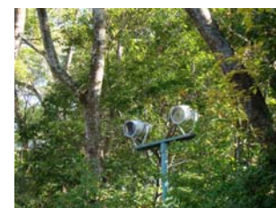
【写真 2. 1. 12】 夜間照明施設
