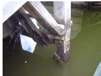
【写真1.5.48】跨虹橋附属橋脚損傷状況（平成16年）
