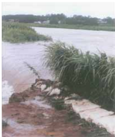
とよとみ 山田川（豊富地区）の破堤 （青森県旧車力村 S56.8.24）
