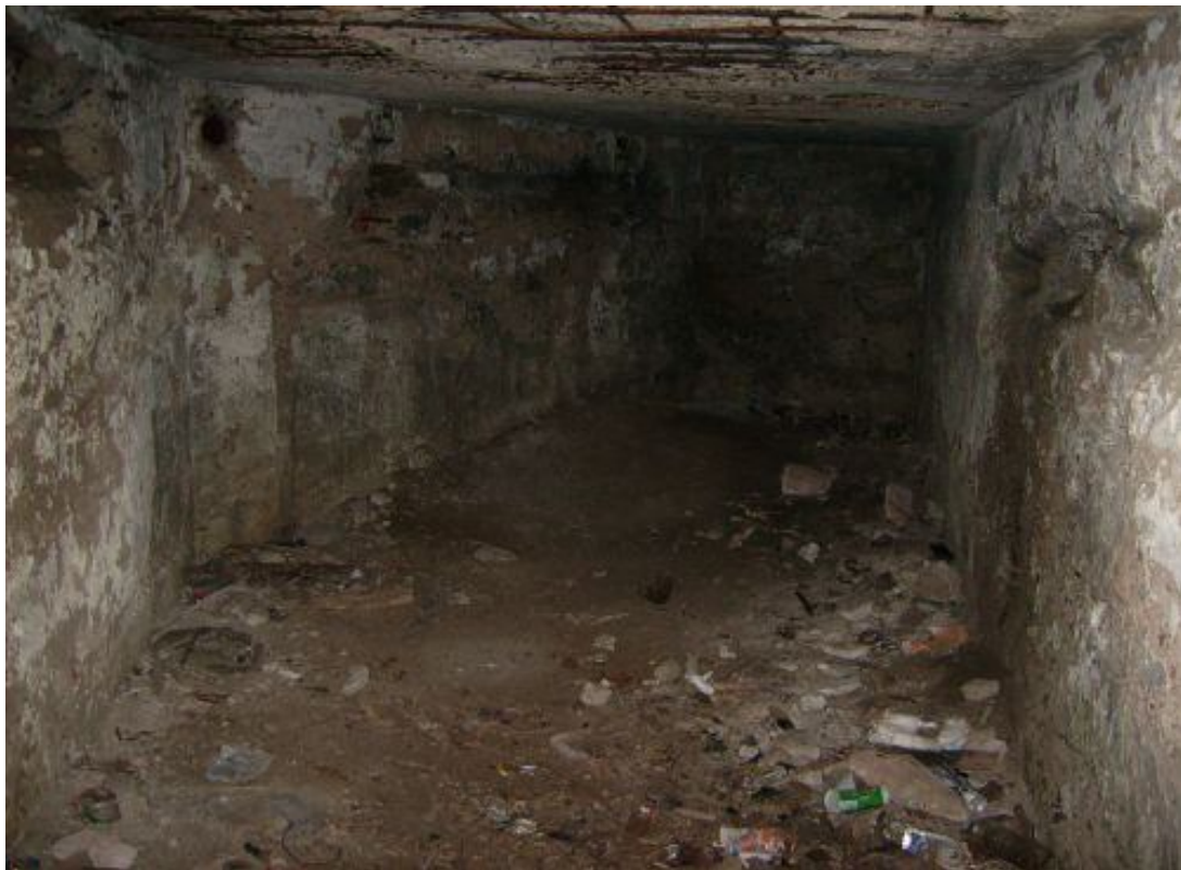
Blick in das Innere, das ziemlich vermüllt ist
