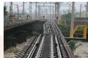
歪みが発生した男里川橋梁
