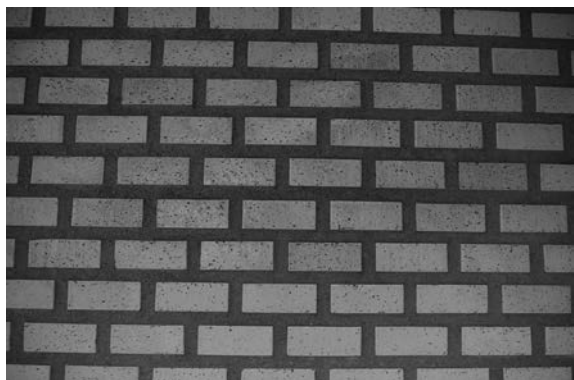
【写真3】シェラトン都ホテル大阪 地下1階廊下壁面の小口タイル
