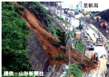
図3 法面崩壊(鶴岡市小岩川地区)
