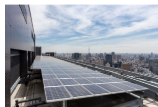
太陽光発電パネル (住宅棟)
