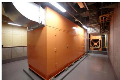
非常用発電機（オフィス・商業棟）
