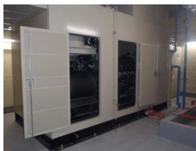
非常用発電機（住宅棟）
