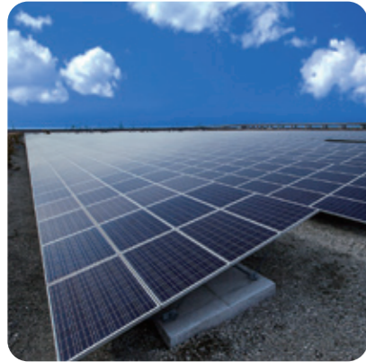
太陽光パネル
