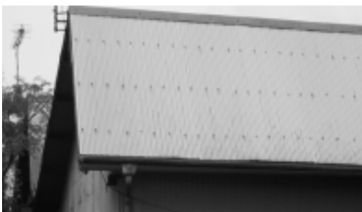
(写真3)採光窓を閉鎖した事例
